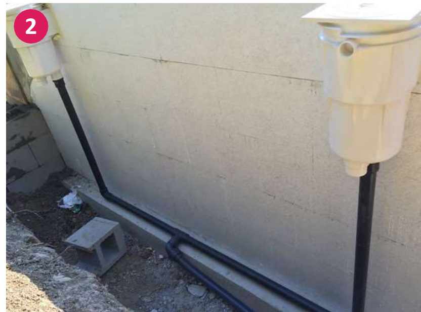
Potrubí pro 2 skimmery
