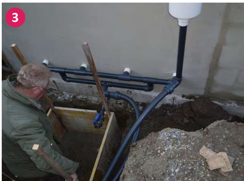
Potrubí trysek, skimmeru a podlahové vpusti
