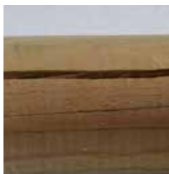
Cracks/Grietas/Fente/Risse/ Crepe/ Barsten/Fendas
